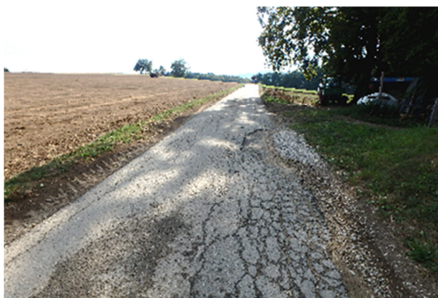
Die landwirtschaftliche Erschliessungsstrasse auf dem Twannberg ist vielerorts stark beschädigt. Bild: zvg
