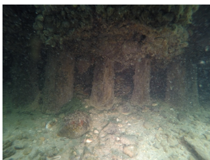
Unterwasser- aufnahme der unterspül- ten See- mauer.
